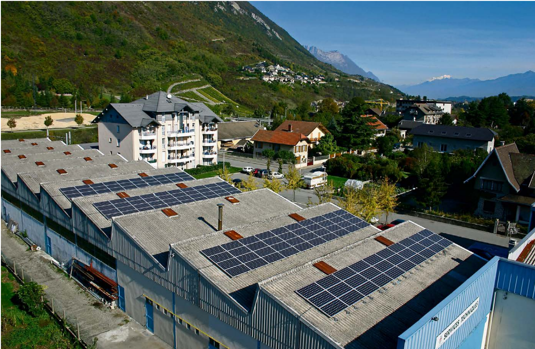
La toiture des ateliers municipaux est couverte de 240 m 2 de panneaux photovoltaïques, qui produisent l'équivalent de la consommation des services techniques de la ville et des quatre véhicules électriques municipaux.
